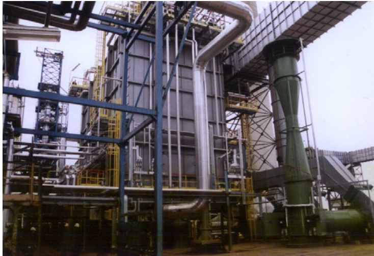
Gdansk Refinery - Crude Heater Gdansk, Poland, 2000 - 2002.
