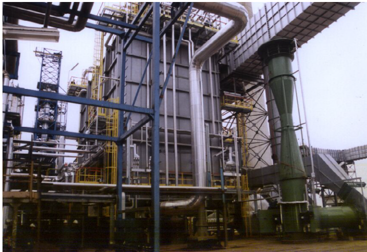
Gdansk Refinery - Crude Heater Gdansk, Poland, 2000 - 2002.
